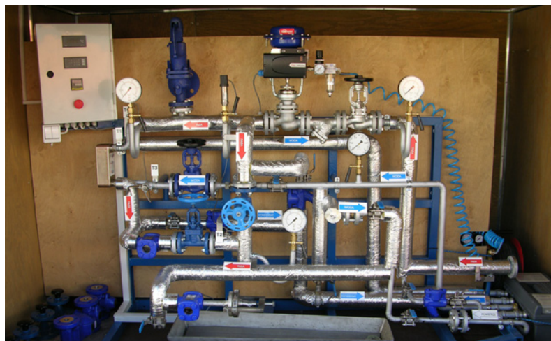
Rys. 2 Wnętrze mobilnej stacji prób
