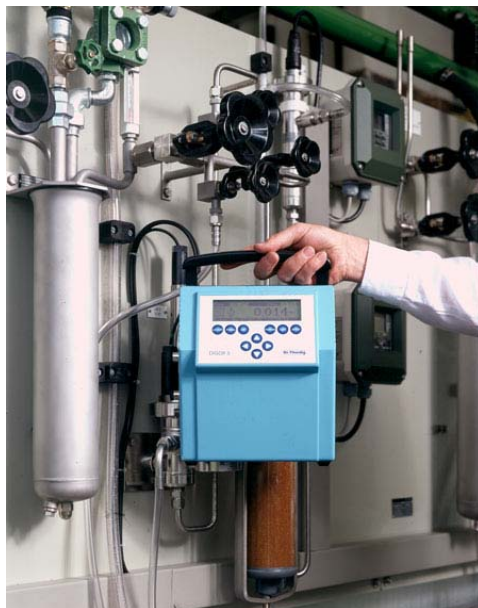
Rys. 16 Automatyczny pomiar przewodności wody kotłowej za chłodnicą próbki na kotłach >60bar
